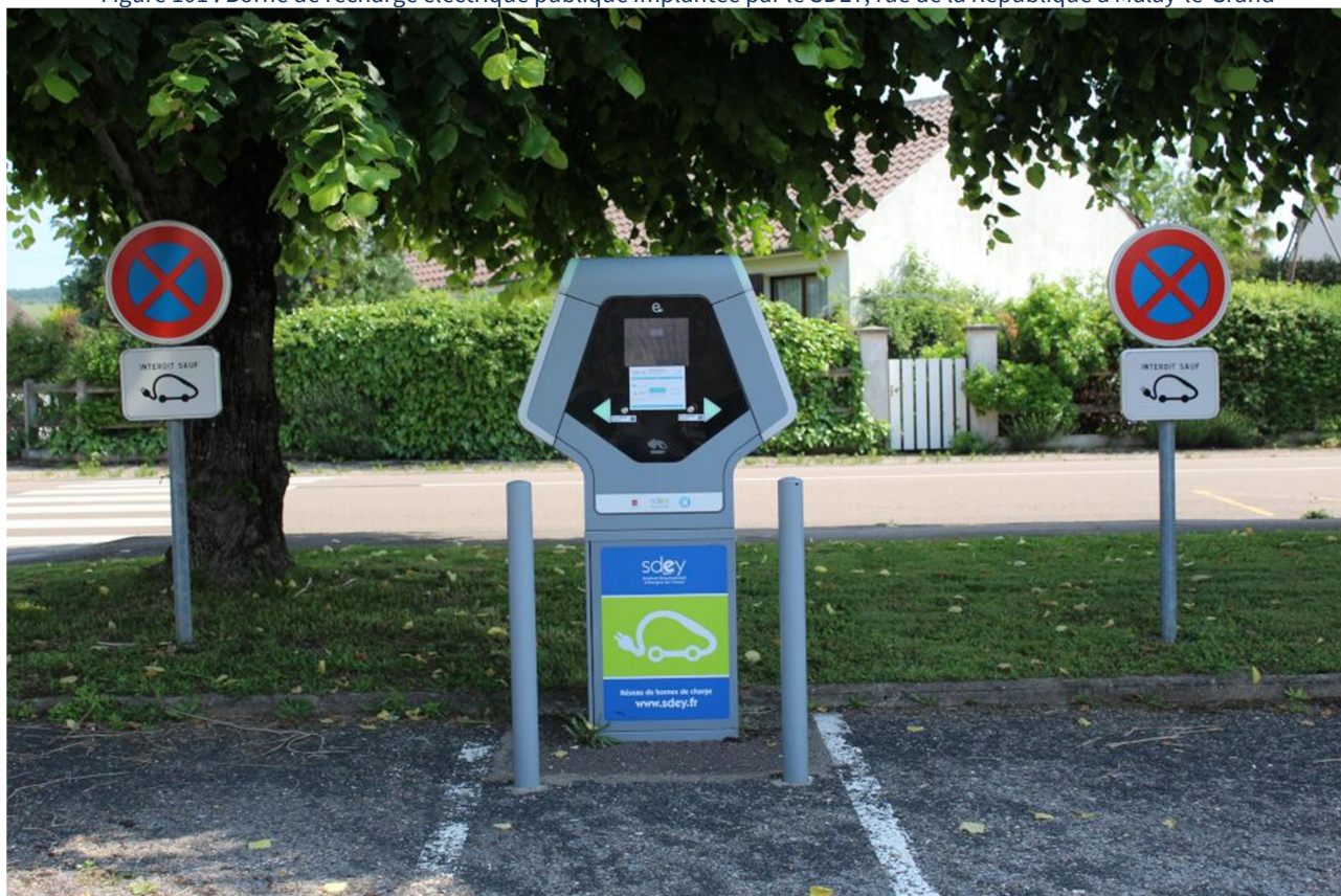
Figure 101 : Borne de recharge électrique publique implantée par le SDEY, rue de la République à Malay-le-Grand
